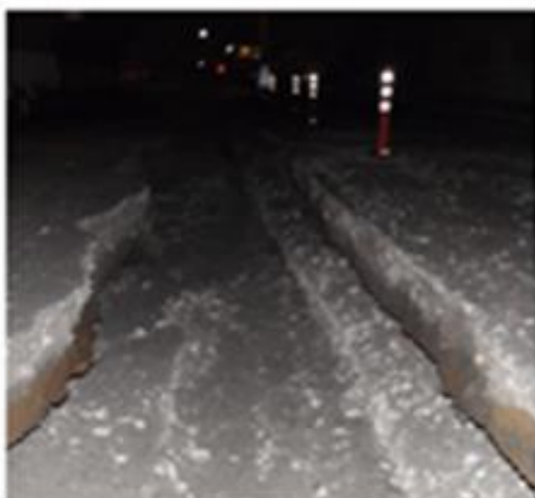
写真 管きよ上の道路陥没
