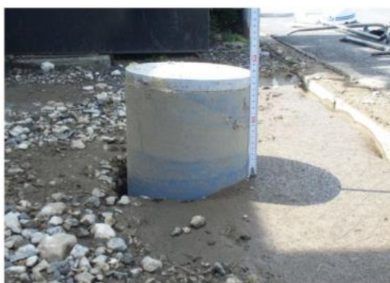
写真 公共ます隆起状況
