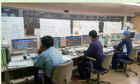
中央管理室において、処理場・ポンプ場の維持管理をしています。
