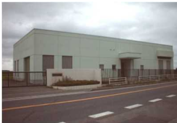
福田汚水中継 ポンプ場
