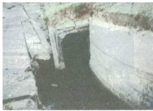
写 2.4.4 流入水路の破損（東灘処理場）
