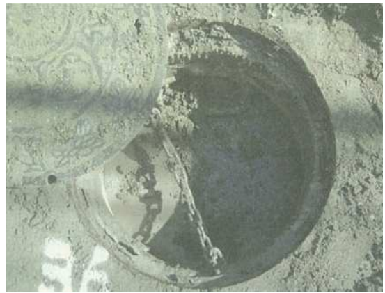
写2.4.10 広域的な周辺地盤の液状化によるマンホール内の土砂堆積
