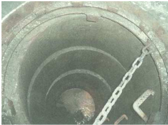
写2.4.9 広域的な周辺地盤の液状化によるマンホール躯体のずれ
