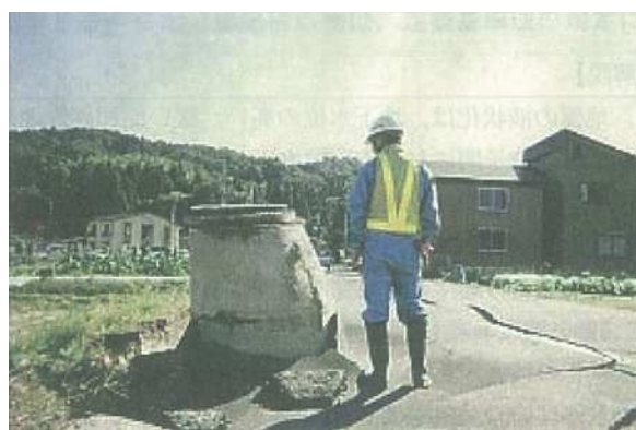
写 2.4.6 マンホールの突出（新潟県中越地震）
