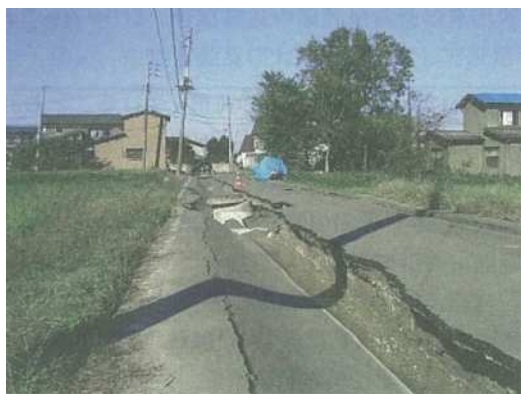
写 2.4.5 埋戻し部沈下（新潟県中越地震）
